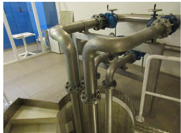
Figure 12 : Equipement de la STAP des Baumes
