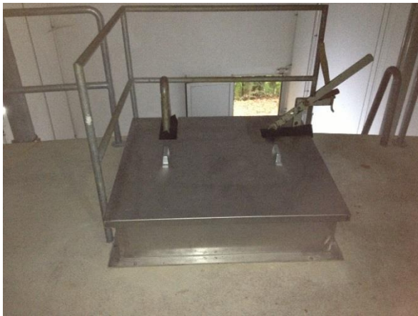
Figure 14 : Equipement du réservoir du Bois des Combes
