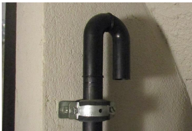
Figure 8 : Système d'aération du Puits des Baumes
