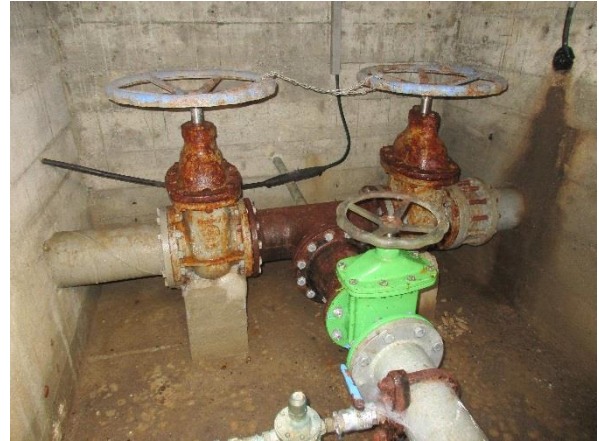
Figure 19 : Equipement de la chambre « Au Praz Derrey »
