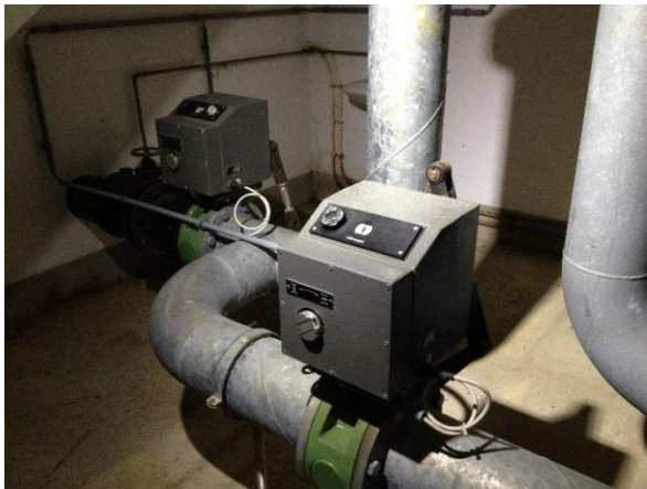
Figure 16 : Equipement du réservoir du Bois des Combes
