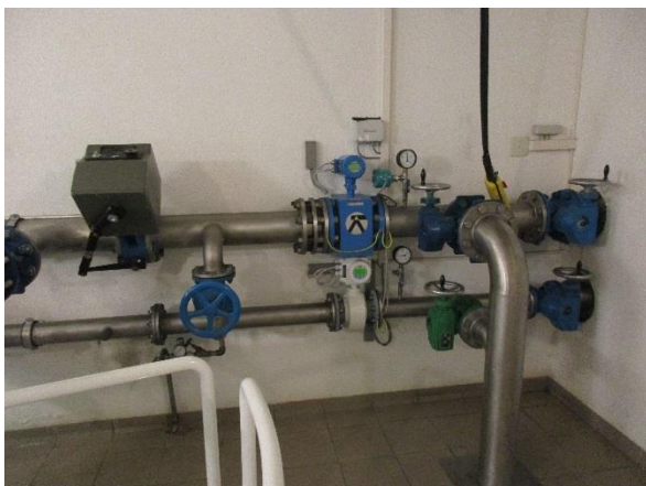
Figure 11 : Equipement de la STAP des Baumes
