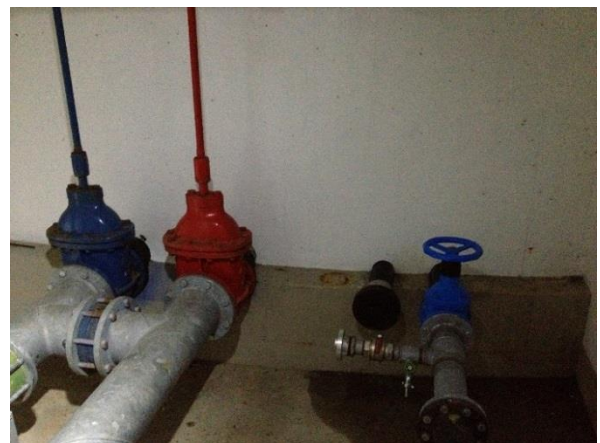
Figure 17 : Equipement du réservoir du Bois des Combes
