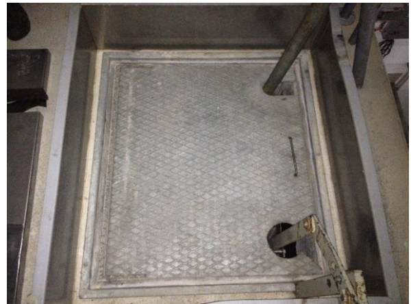
Figure 15 : Equipement du réservoir du Bois des Combes
