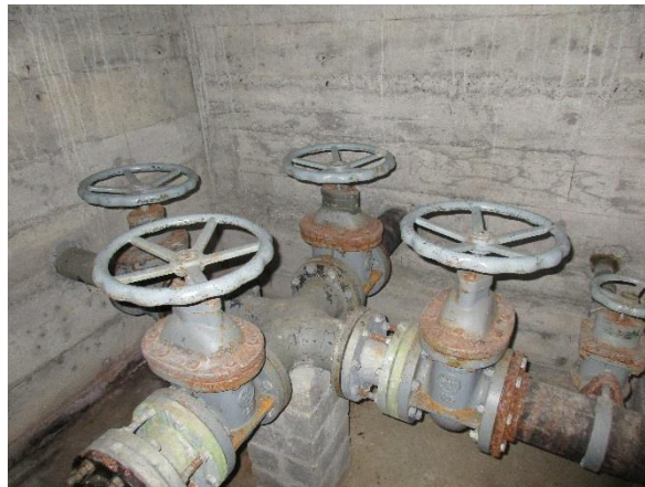
Figure 20 : Equipement de la chambre de vannes incendie du CLA
